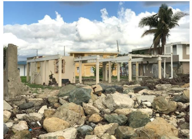
Imagen 2. Estructura con daños severos en la Zona Costera de Punta Santiago.
