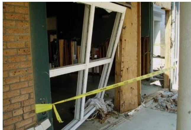
Imagen 3. Falla de la pared con marco de madera, de la chapa de ladrillo y de las ventanas debido a 4 pies de inundación de aguas tranquilas y olas pequeñas. Huracán Katrina en Misisipi.
