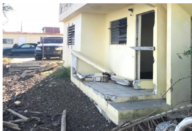
Imagen 4. Fallo de cimientos tipo Zona A en un área costera, no sujeta a las condiciones de la Zona V.
