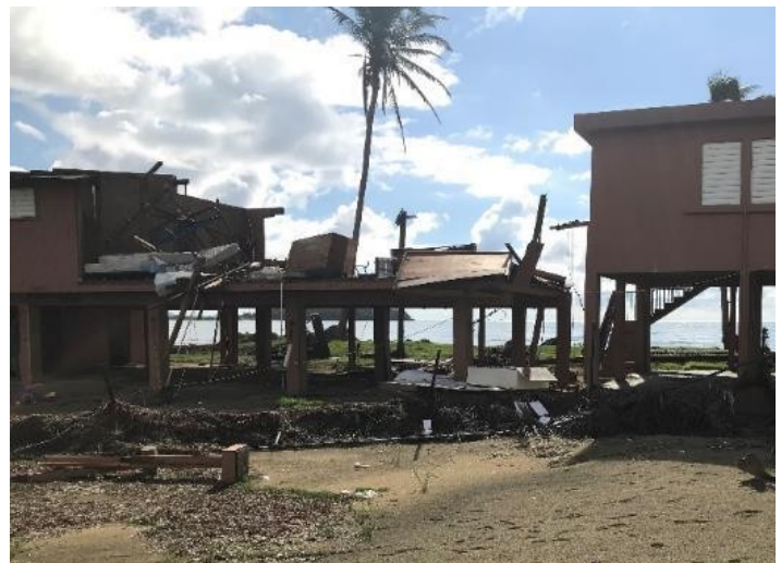
Imagen 10. Los cimientos de la estructura sobrevivieron, pero no pudieron resistir los fuertes vientos.
