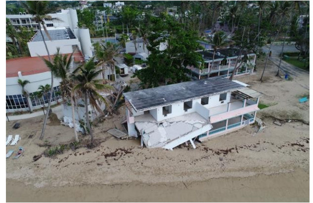
Imagen 1. Falla de la estructura sujeta a oleaje, olas y erosión.
