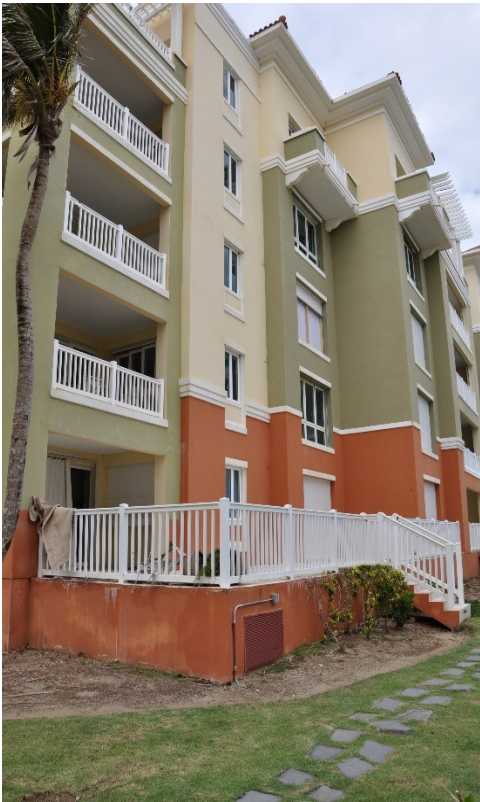
Imagen 5. En este edificio frente al mar, muchas ventanas operables con toldos y abatibles sufrieron daños por las presiones del viento y los escombros arrastrados por el viento.
