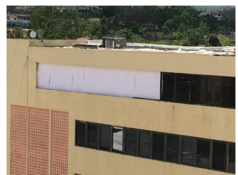
Imagen 8. Falta todo un ventanal en el piso más alto de este hospital en Bayamón debido a la falta de abrazaderas adecuadas.
