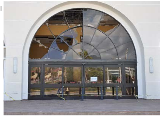
Imagen 9. Cristales dañados en la entrada principal de un edificio/centro de convenciones de la comunidad.
