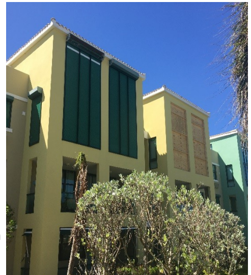
Imagen 1. Ventanas residenciales protegidas (izquierda) y sin protección (derecha). Las ventanas sin protección sufrieron daños y fueron cubiertas provisionalmente con paneles de madera.
