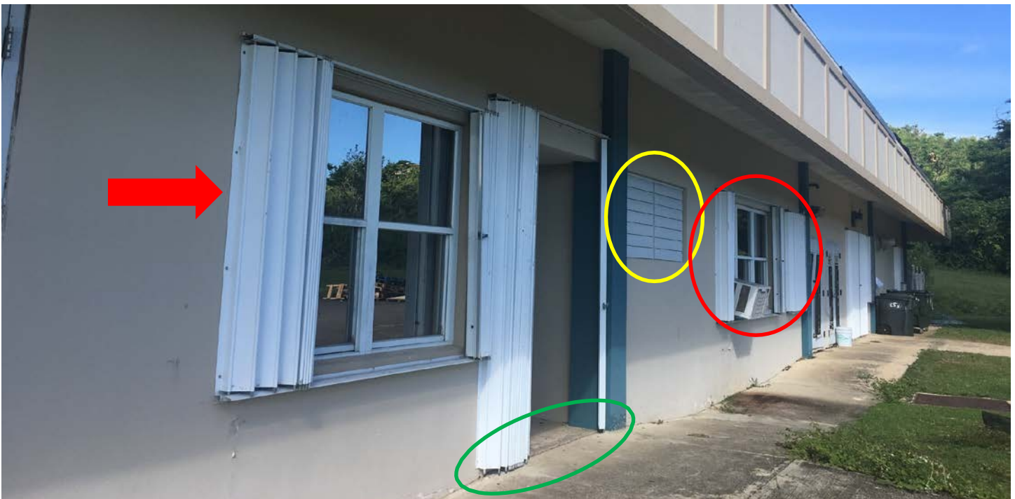
Imagen 13. Los problemas de instalación que afectaron el desempeño de los sistemas resistentes a impactos incluyen: la falta de un riel inferior (óvalo verde), la unidad de aire acondicionado en la ventana que impidió cerrar la tormentera (círculo rojo), y una apertura con celosías de metal sin sistema de resistencia a impactos (círculo amarillo).
