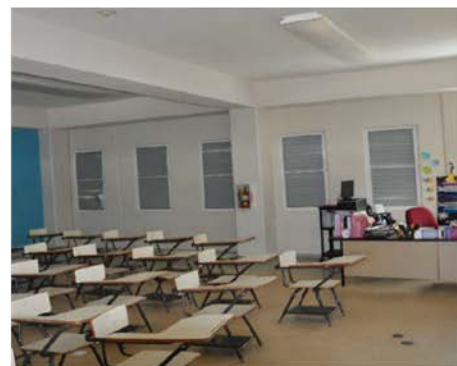
Imagen 4. Escuela superior en una comunidad costera con aperturas con celosías de metal. Se instalaron mallas para insectos detrás de las aperturas con celosías.
