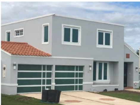
Imagen 6. Ventanas fijas y con partes móviles en una casa que no fallaron.
