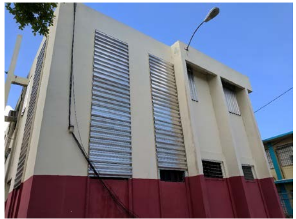
Imagen 12. Estación de bomberos con sistema de tormenteras de metal instalado protegido adecuadamente la instalación.
