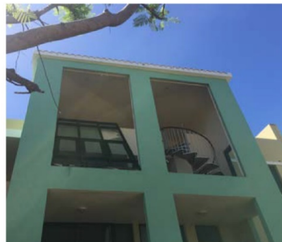
Imagen 7. Unidades de ventanas en dos pisos (fijas y móviles) que fallaron en la conexión entre el marco y la pared debido a la falta de abrazaderas correctas.
