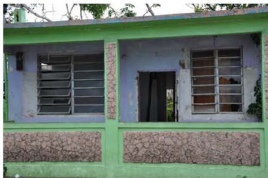
Imagen 2. Residencia en la que escombros arrastrados por el viento dañaron las hojas de cristal sin protección a la derecha e izquierda de la puerta de entrada.
