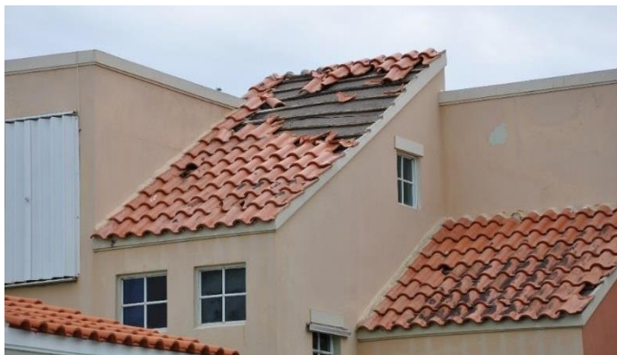
Imagen 3. Techo con tejas dañadas.
