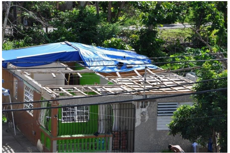
Imagen 2. Techo de metal corrugado dañado. El techo no tenía cubierta de madera laminada armazón de soporte ni conexiones de techo adecuadas.
