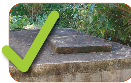
Pozo séptico con tapa de concreto
