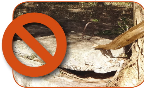
Repare las tapas rotas de los pozos sépticos
