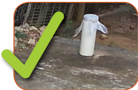
Tubería de ventilación de un pozo séptico con malla protectora
