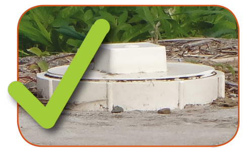
Pozo séptico sellado con tapa de PVC
