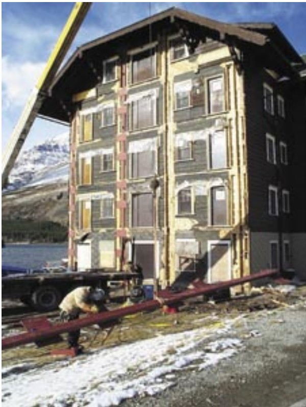
El trabajo está en camino para estabilizar el Glacier Hotel, un Sitio Histórico Nacional, en Glacier National Park (MT).
